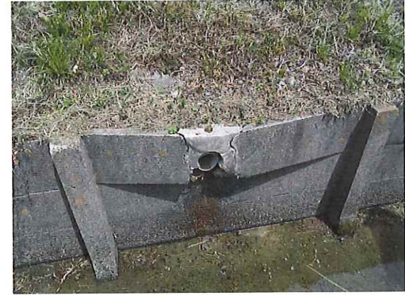
1班 K-11 新田地内 コンクリート板破損
