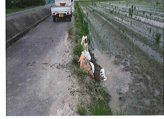
k-18 唐生地内 田面漏水
