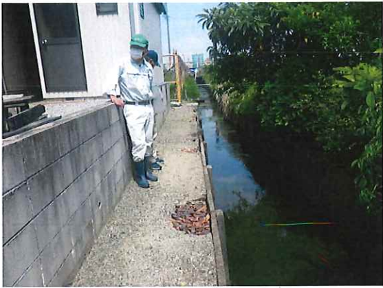
2班 K-14 青木地内 排水路沿土砂流出
