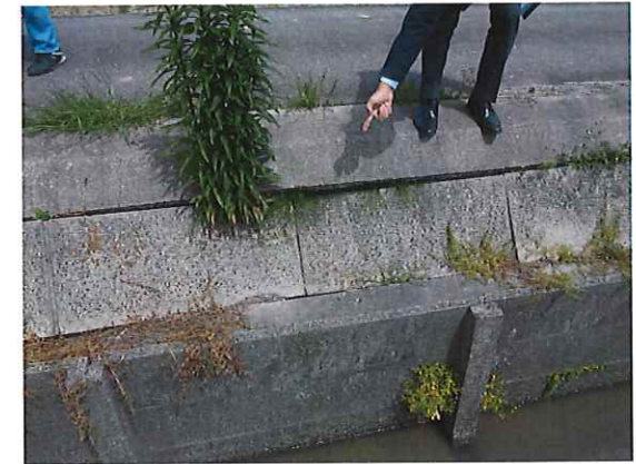
1班 K-5 新田地内 法面の落下20m
