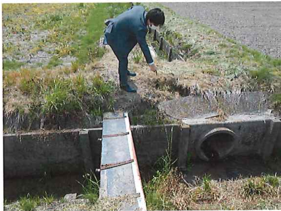
1班 K-8 新田地内 法面の崩壊
