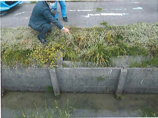
1班 k-7 新田地内 法面の崩壊
