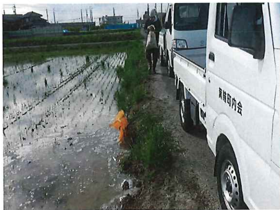
k-18 唐生地内 田面漏水
