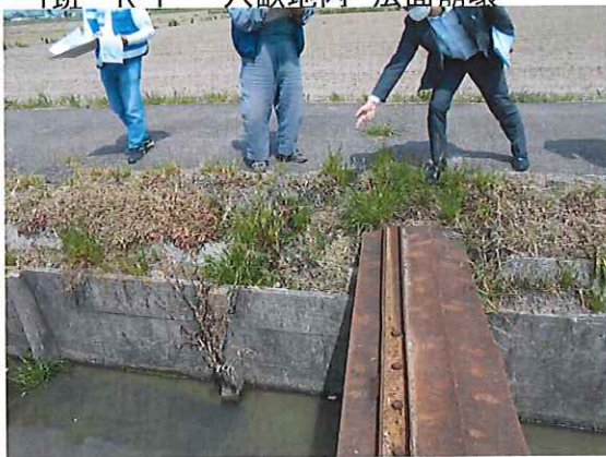
1班 k-3 六畝地内 法面崩壊
