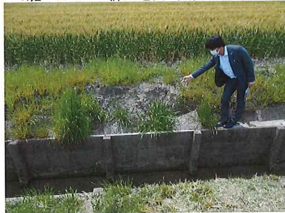
1班 K-10 新田地内 法面の崩壊
