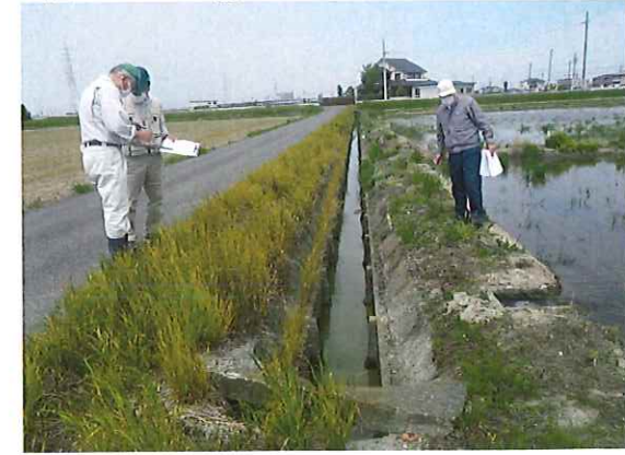
2班 k-13 唐生地内 法面崩壊
