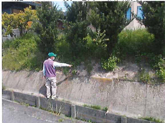
3班 K-16 切戸地内 法面崩壊
