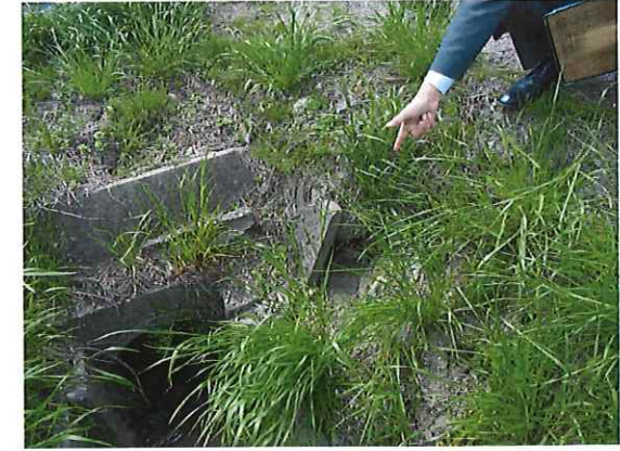
1班 K-6 新田地内 法面の崩壊
