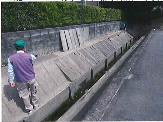
3班 K-15 切戸地内 法面崩壊
