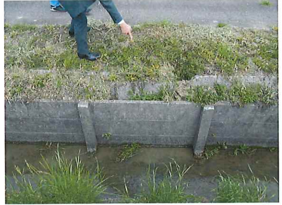
1班 k-7 新田地内 法面の崩壊
