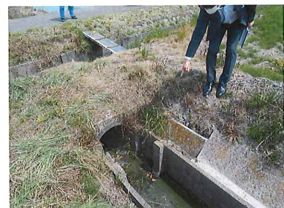
1班 K-9 新田地内 法面の崩壊
