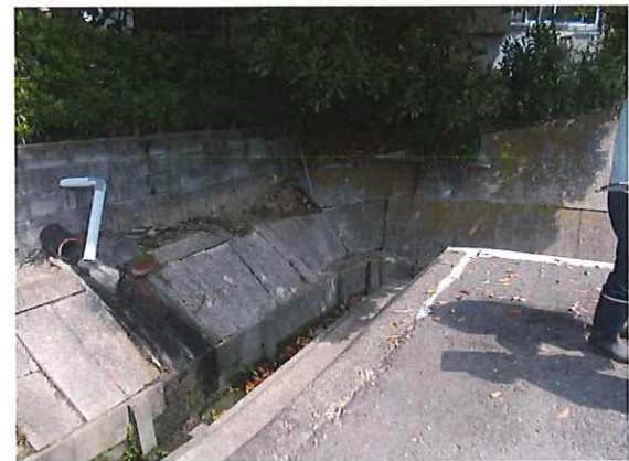
3班 K-15 切戸地内 法目面崩壊
