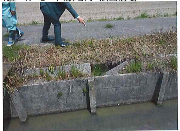
1班 K-3 六畝地内 法面崩壊 10m
