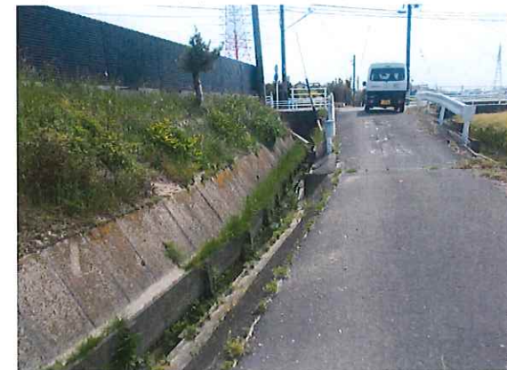
3班 K-16 切戸地内 法面崩壊
