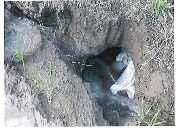
k-18 唐生地内 田面漏水
