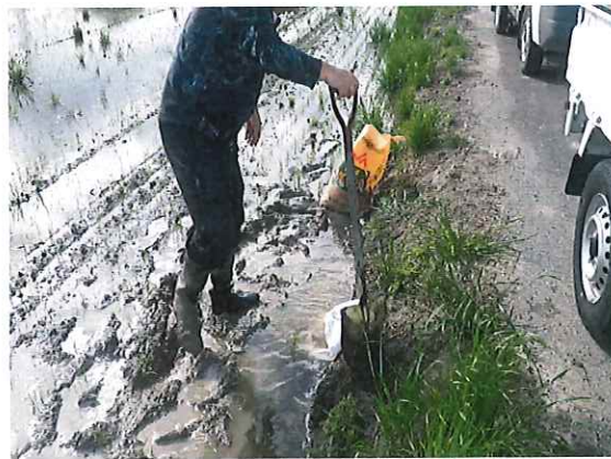
k-18 唐生地内 田面漏水
