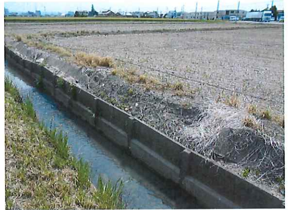
1班 k-2 六畝地内 法面崩壊
