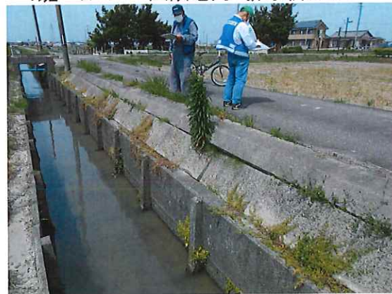
1班 K-5 新田地内 法面の落下20m
