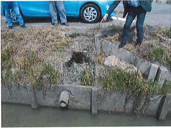
1班 K-1 六畝地内 法面崩壊
